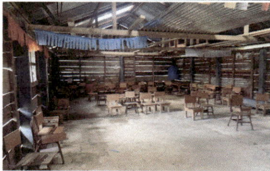
Foto 3: Piso con grietas.
