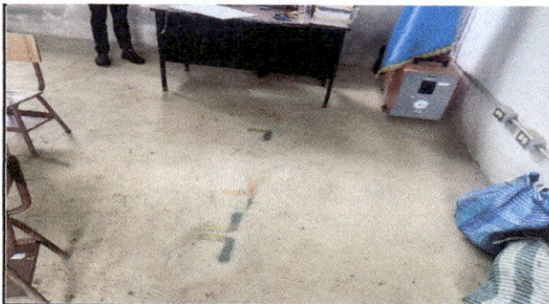
Foto 5: piso en malas condiciones.
