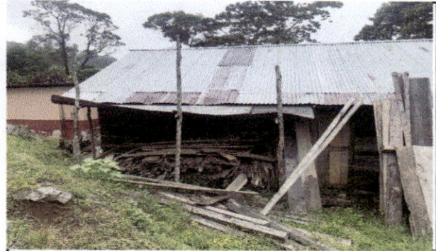
Foto 2: Estructura de techo de lamina en muy malas condiciones.
