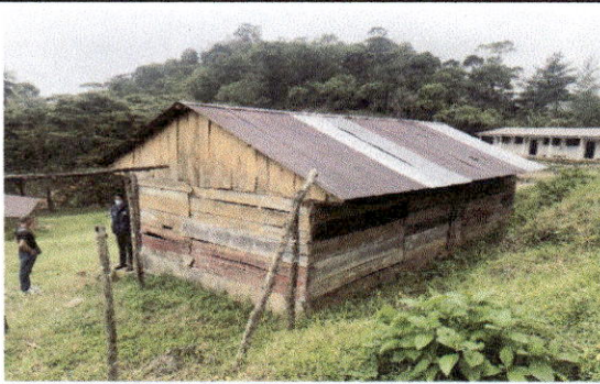
Foto 7: Techo de lamina en mal estado por corrosión.
