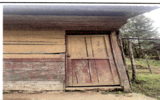
Foto 6: Puerta de madera desgastada en cocina.
