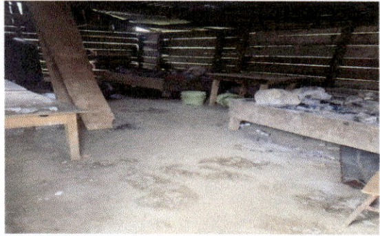
Foto 8: Piso en pésimas condiciones en cocina.
